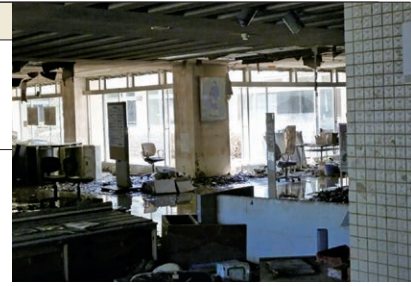
1階天井上まで浸水した市真備支所
