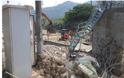
被災した排水機場
