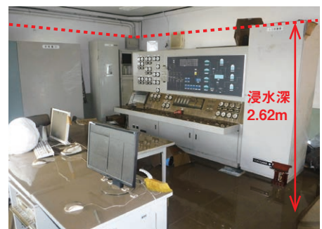
冠水した真備浄水場の中央監視室
