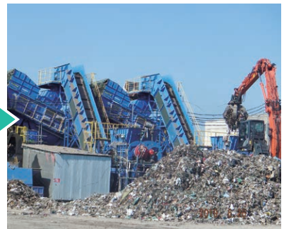
二次仮置場に設置した中間処理施設
