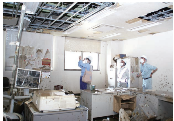
天井まで浸水した真備浄化センター内部の様子
