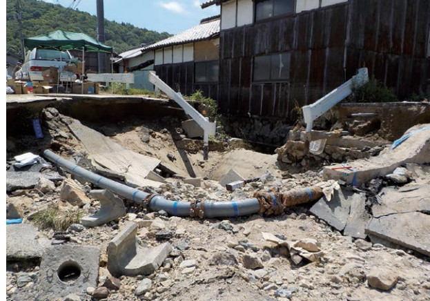
水道管の破損状況(真備町服部)
