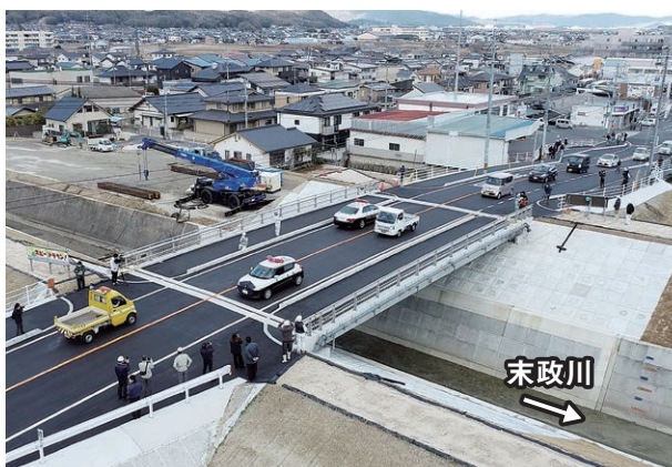
末政川の堤防整備に併せて架け替えた有井橋が開通＝令和4年12月26日
