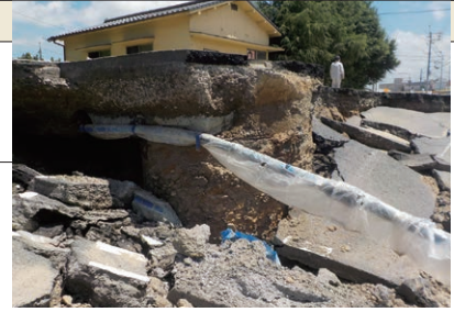
露出した水道管
