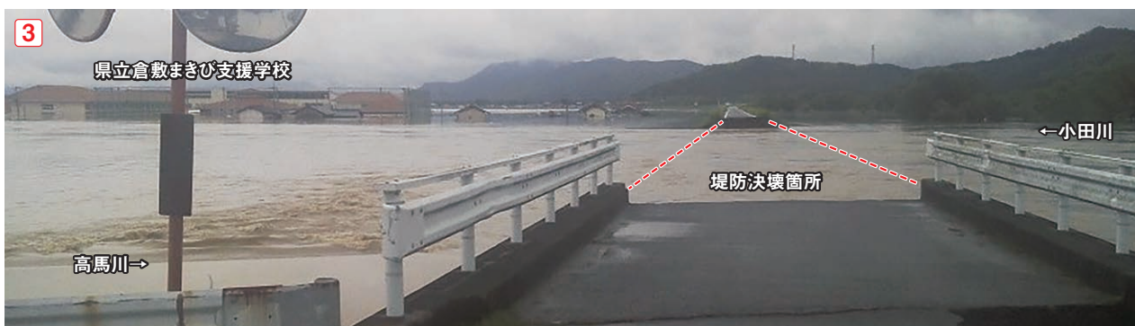
決壊した小田川堤防=7月7日、真備町箭田
