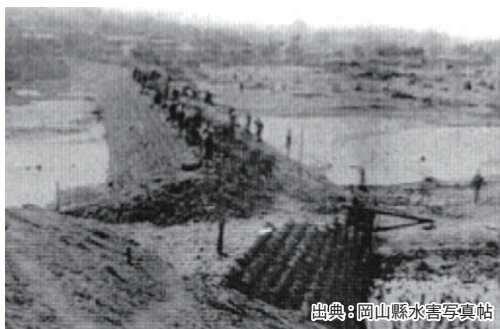
明治26年10月洪水 堤防決壊の復旧状況 (倉敷市真備町川辺)
